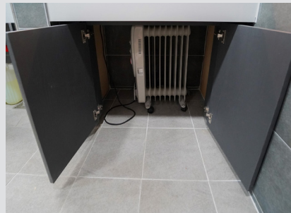
기저귀교환대 하부에 라디에이터 설치
