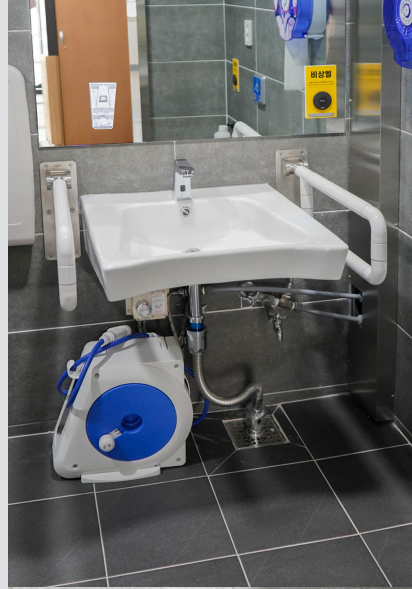
다목적 화장실 내 세면대, 하부에 샤워기 설치
